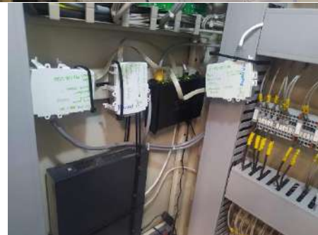
Área de medidores con su respectivo sistema de comunicación.
