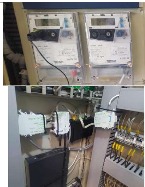
Área de medidores con su respectivo sistema de comunicación.
