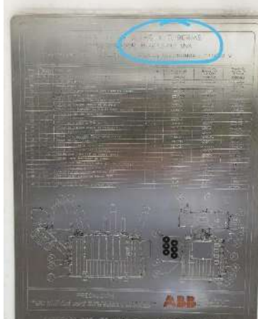
Un transformador de distribución con capacidad instalada de 90000 KVA.
